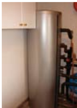
Opslagvat van de zonneboiler.
